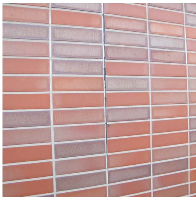
タイル目地ひび割れ補修痕跡
