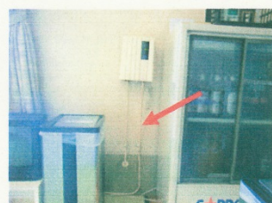
後付け灯油配管
