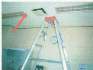
天井付換気扇
