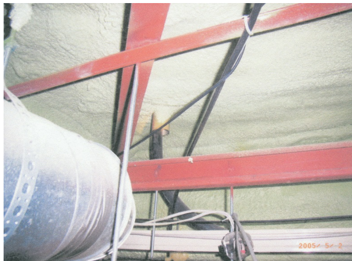
キューピクル幹線屋内引込口
