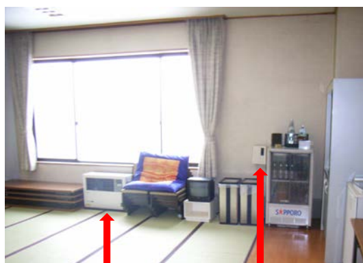
FF 灯油暖房機 オイルサーバー
