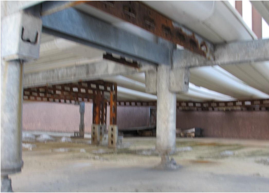
エアコン冷媒管架台脚部
