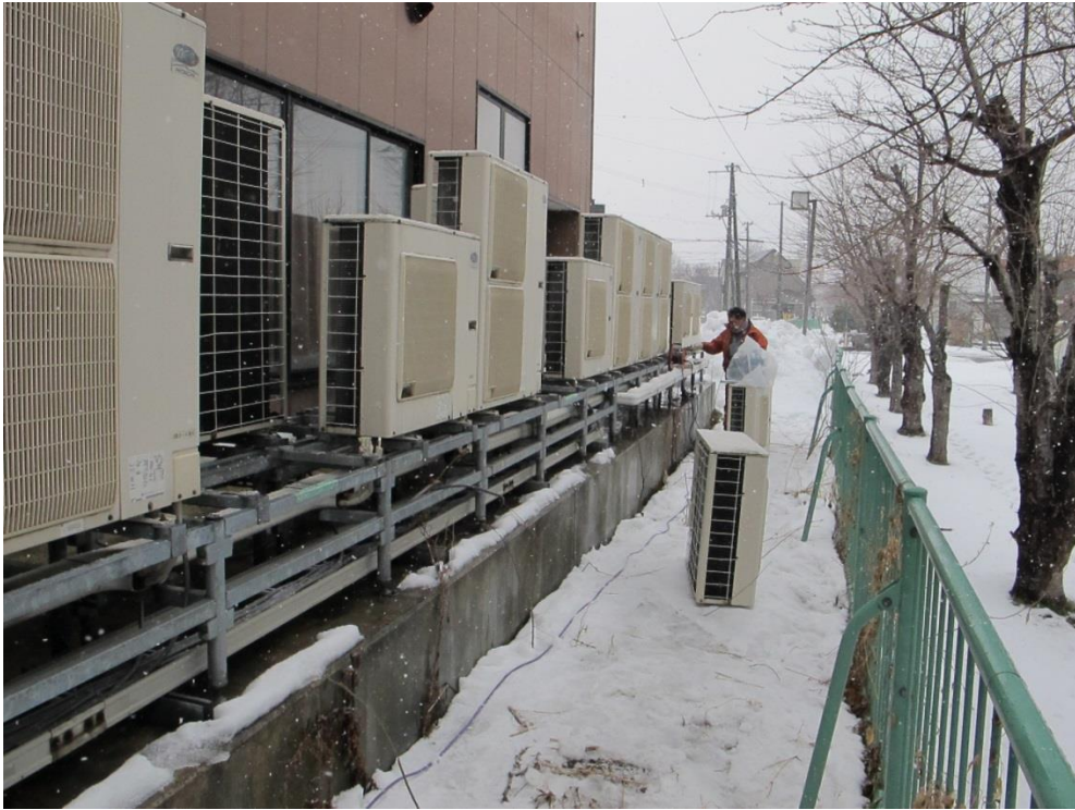
敷地東側 エアコン室外機
