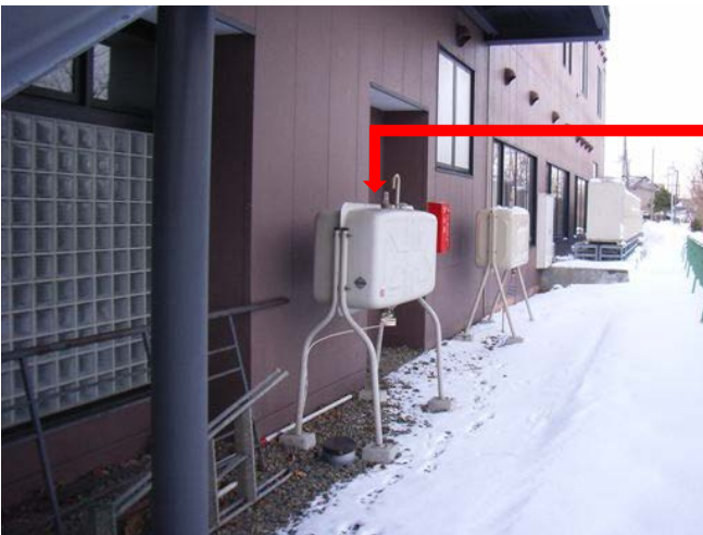
ロードヒーティングボイラー用給油 ホームタンク
