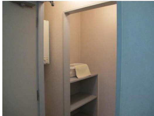
ガス給湯器スペース・脱衣室
