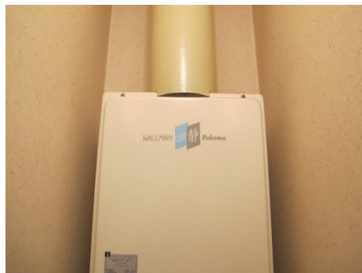
男子洗面室 ガス給湯器
